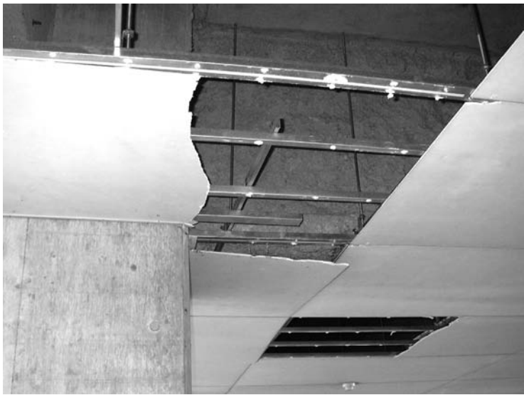
封じ込め処理していたアスベストが飛散したケースも
