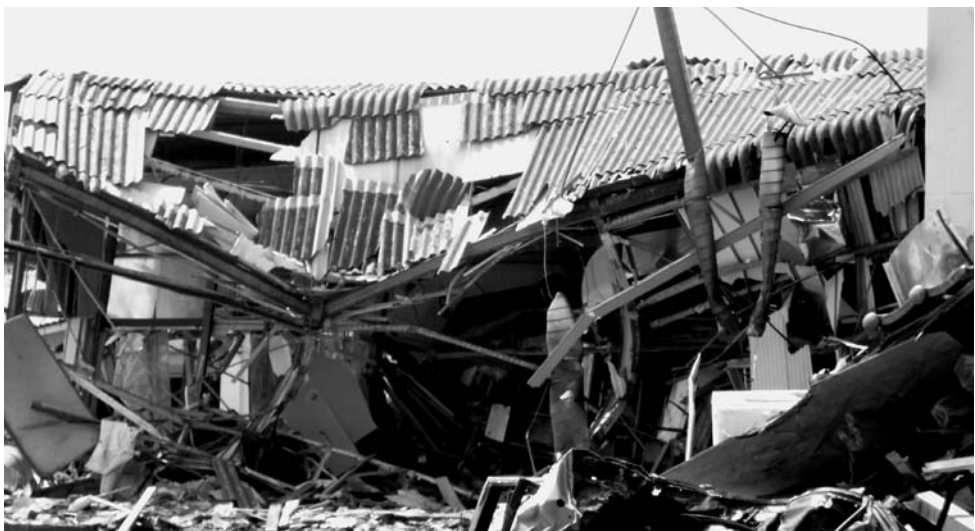
津波被害を受けた海側の建築物については屋根などにスレート波板を使用しているものも多かった
