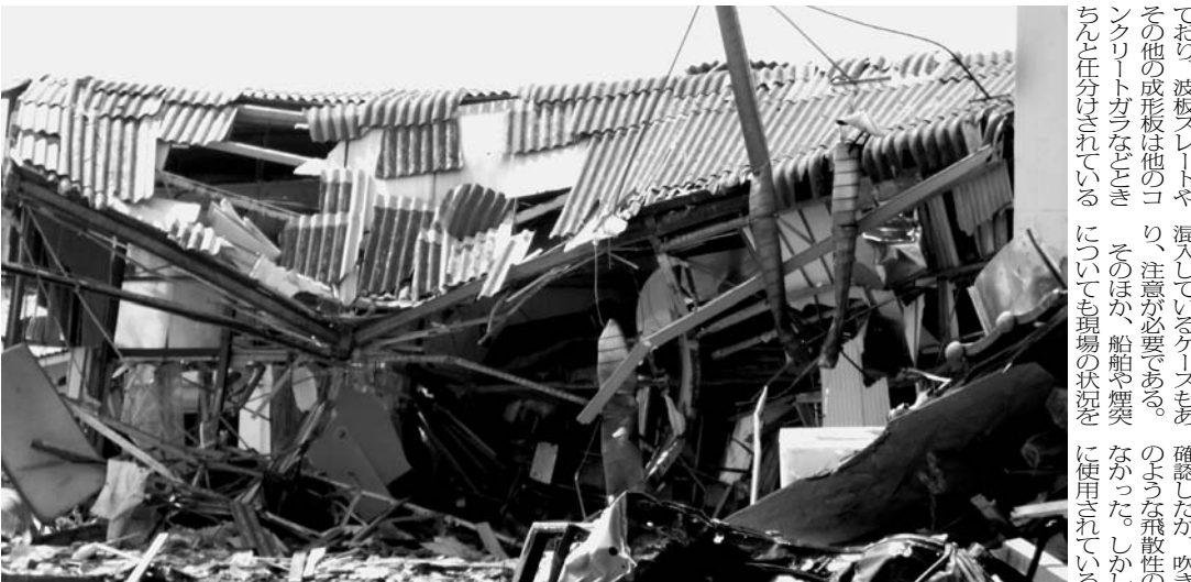
津波被害を受けた海側の建築物については屋根などにスレート波板を使用しているものも多かった
