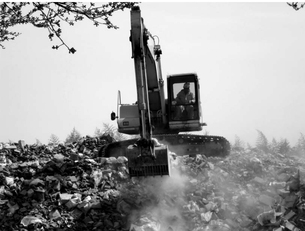
通常ではアスベストが飛散しないような成形成でも重機で仕分けする際に飛散してしまう恐れがある
