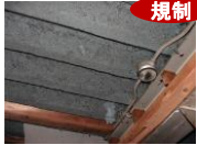
吹付けアスベスト
