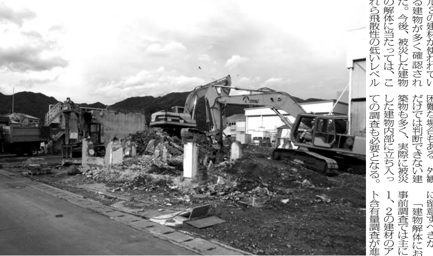
がれきに混入しているアスベスト含有廃棄物の対策については、依然として明確なルールが決まっていない
